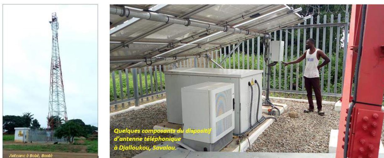
PHOTO 1 : UNE ANTENNE DE TELEPHONIE MOBILE
